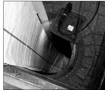
Mit einem Kunststoffschlauch wird das marode Kanalrohr in der Gartenstraße saniert. Die betroffenen Bewohner wurden angeschrieben.
